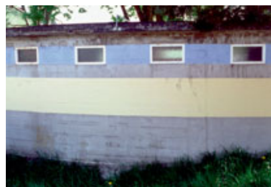
Von drei Seiten her wird das Schwimmbad von einer Mauer umfasst, in welche die Einzelkabinen untergebracht sind. Das Bild zeigt die Mauer vor der Sanierung.
