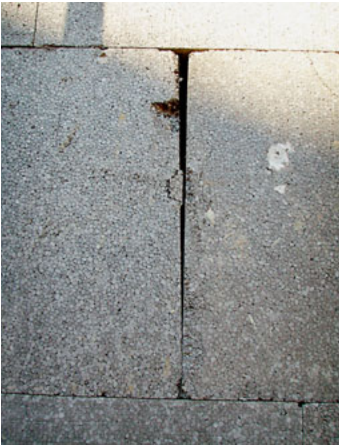
8 Fehlstellen in der Wärmedämmschicht sind mit Dämmstoffkeilen zu schliessen.
