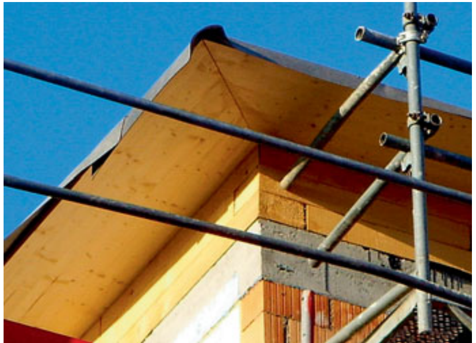
1 Dachrandabschlüsse aus Massivholz und mehreren Materialwechselln neigen zu Verformungen, die manche Aussenwärmedämmung über kurz oder lang überfordern. Es kommt zu Rissbildungen, Plattenablösungen und undichten Anschlüssen.
