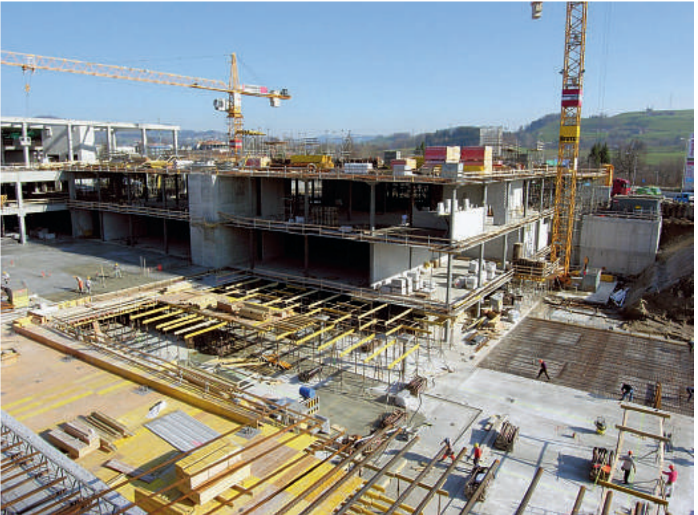
Stadion-Grossbaustelle in St. Gallen: Die AFG-Arena, benannt nach der Arbonia-Forster-Holding mit Sitz in Arbon, ist das erste Schweizer Stadion, das nach einem kommerziellen Unternehmen benannt wird. Es löst ab 2008 das Dauerprovisorium Espenmoos ab.
