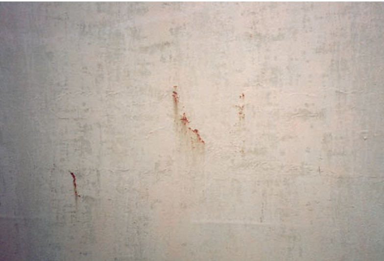
2 Eine Beschichtung mit vereinzelt Roststellen und stark abgewitterter Deckbeschichtung. Hier wird mit Ausflecken und einem Deckanstrich saniert.
