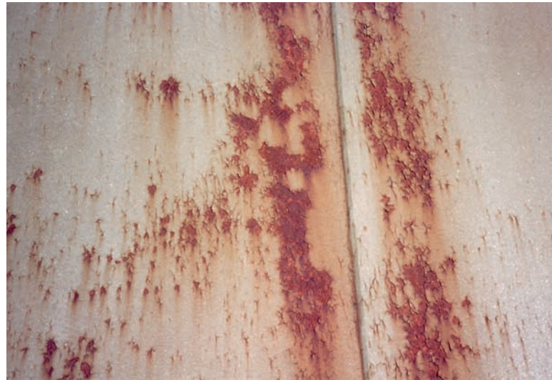
3 Die Beschichtung ist stark verwittert und grossflächig abgeblättert. Sie erfüllt ihre Schutzfunktion nicht mehr. Es muss neu beschichtet werden.
