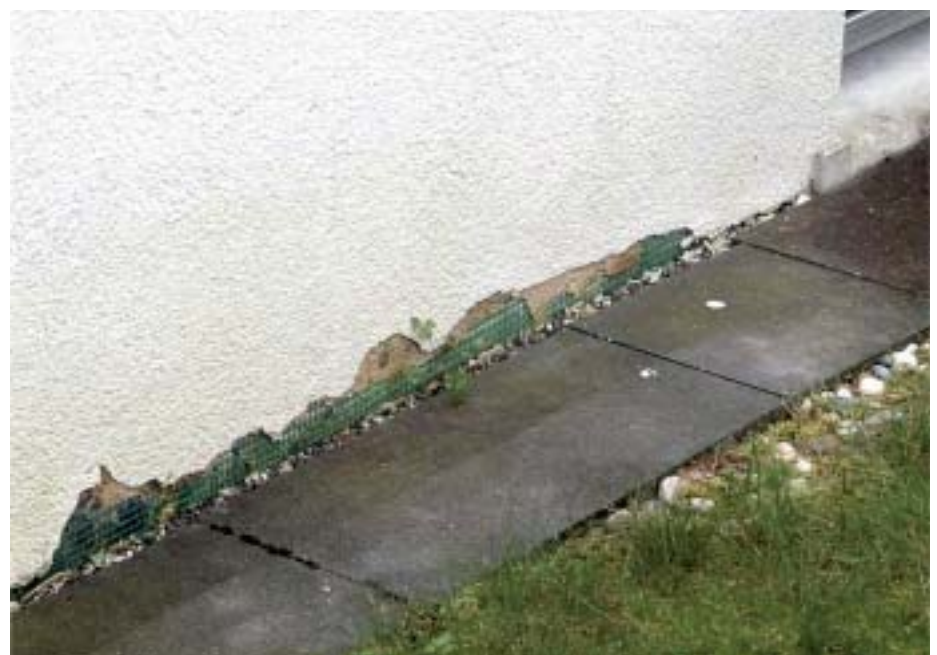
4 Wegen der fehlenden Schutzbeschichtung und der übrigen Sockeldetails, wie an die Hauswand herangeführte Zementplatten, die ein Gefälle zur Wand hin aufweisen, konnte Feuchtigkeit nachhaltig auf die Deckschicht einwirken. In der Folge erlitt der Putz den sichtbaren Schaden.
