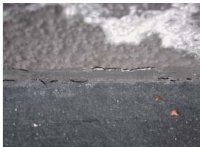
11 Die Kittfuge hat sich an den Flanken bereits abgelöst. Bei der Fuge wurden zwei Fehler begangen: Es wurde kein Hinterfüllprofil verwendet, was gemäss der SIA-Empfehlung V274, «Fugenabdichtungen in Bauwerken», unbedingt erforderlich ist, um der Fuge eine Dehnzone zu verleihen. Weiter wurde die Kittfuge auf den Deckputz und nicht auf den Grundputz aufgebracht. Ausserdem sind liegende Fugen zu vermeiden, da sie sehr schnell altern und dabei undicht werden.
