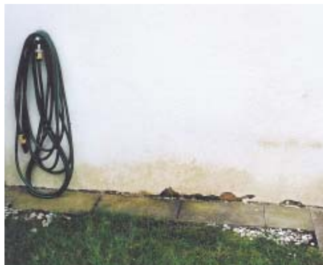
6 Algenbewuchs im Spritzwasserbereich. Der Bewuchs auf den Zementplatten weist darauf hin, dass der Sockel nur wenig besonnt ist und die Deckbeschichtung lange feucht bleibt.
