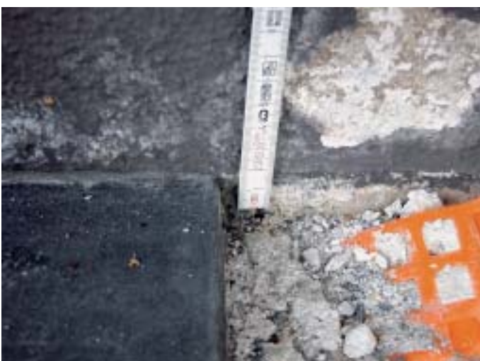
10 Die Natursteinplatten wurden mit einem nur sehr geringen Gefälle an die Aussenwand angeschlossen. Im Bereich der Platten wurde keine Schutzbeschichtung ausgeführt. Der Anschluss an die Hauswand erfolgte mit einer Kittfuge. Nach relativ kurzer Zeit entstanden weisse Ausblühungen, verursacht durch Feuchtigkeitseinwirkung auf den Putz.
