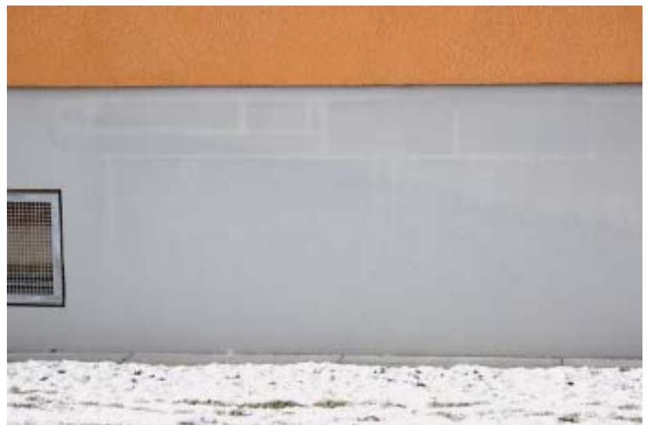
8 Durch das Schwinden der XPS-Platten entstanden Wärmebrücken, die sich auf dem Putz abzeichnen.
