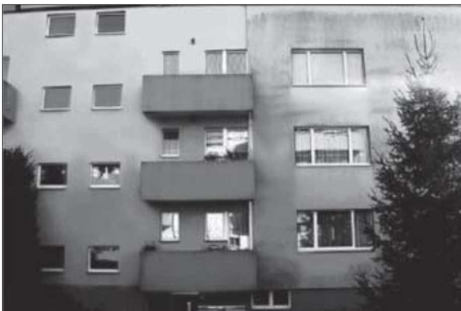
1 Wärmedämmungen erhöhen die Gefahr von Algenbewuchs. Hier eine gegen Nordosten exponierte fünf Jahre alte Fassade, deren rechte Hälfte wärmedämmend ist und mikrobiellen Bewuchs aufweist, während die linke, nicht gedämmte Hälfte bewuchsfrei geblieben ist.
