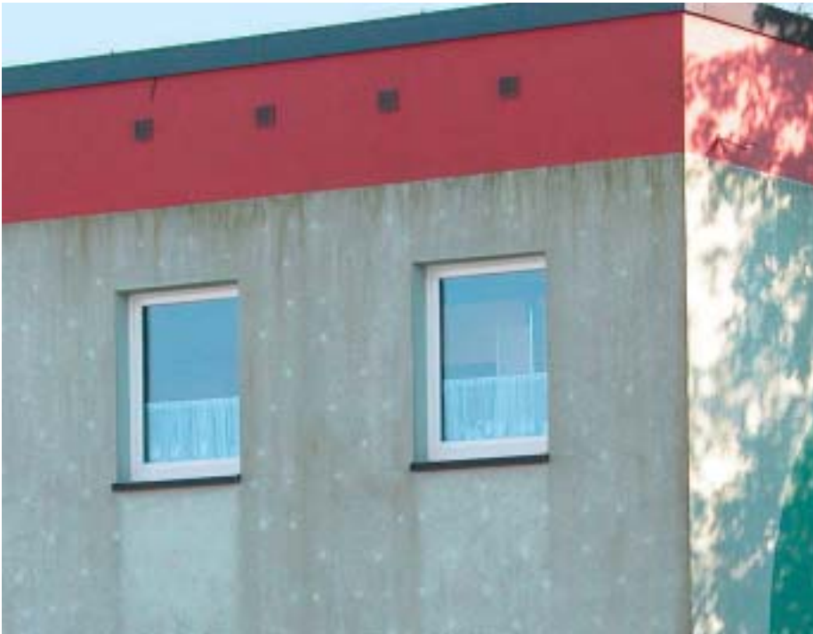
4 Algenbildung an einer Fassade mit Wärmedämmverbundsystem. Die Dübel zeichnen sich als helle, nicht befallene Stellen ab. Die dort geringfügig höhere Temperatur genügt offenbar zur Verhinderung von Algenbefall.
