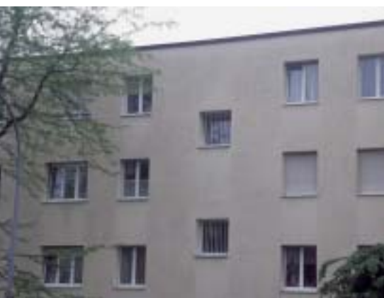
1 Fleckige Fassade: Die Fachleute von QC-Expert fanden heraus, dass der Schaden durch Schimmelpilzbefall verursacht wurde.
