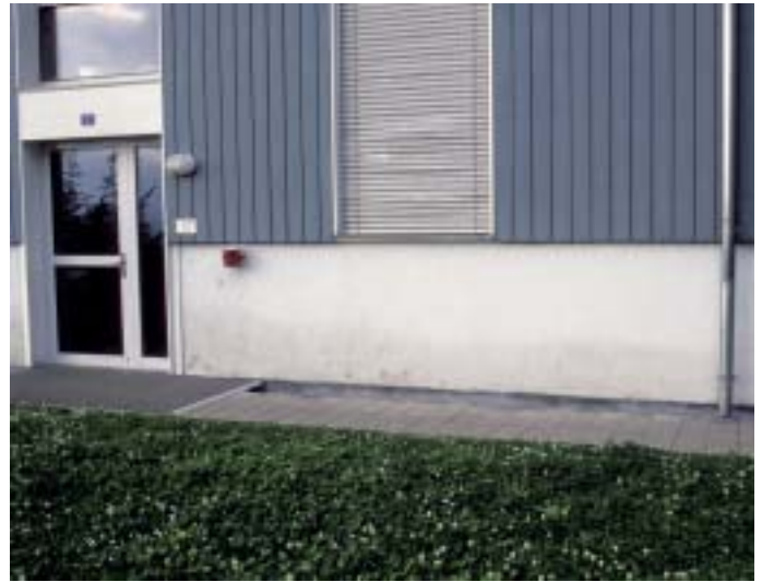
3 Aufsteigende Feuchtigkeit verursachte Flecken im Sockelbereich des Verputzes.
