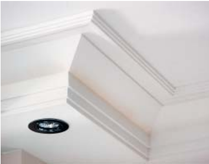
2 Vermutlich ein Malerfehler: Die Innenkante eines gestrichenen Stuckprofils verfärbte sich.
