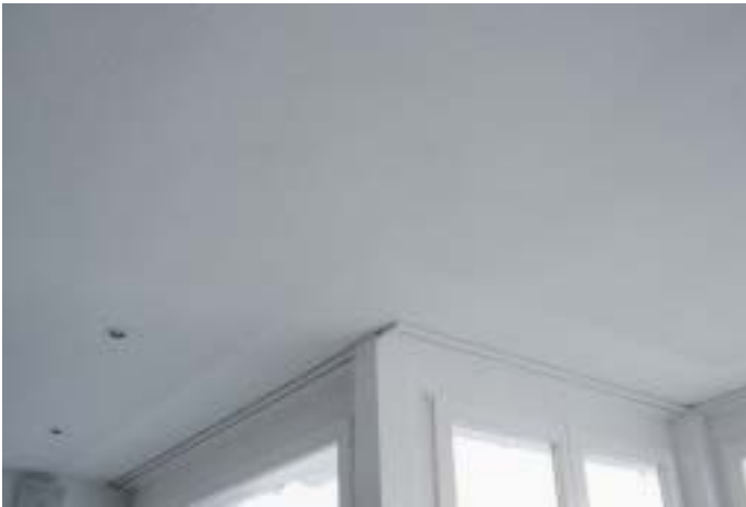
4 Die in der Decke über den Fenstern eingelegten Wärmedämmstreifen zeichneten sich durch Verfärbungen ab.
