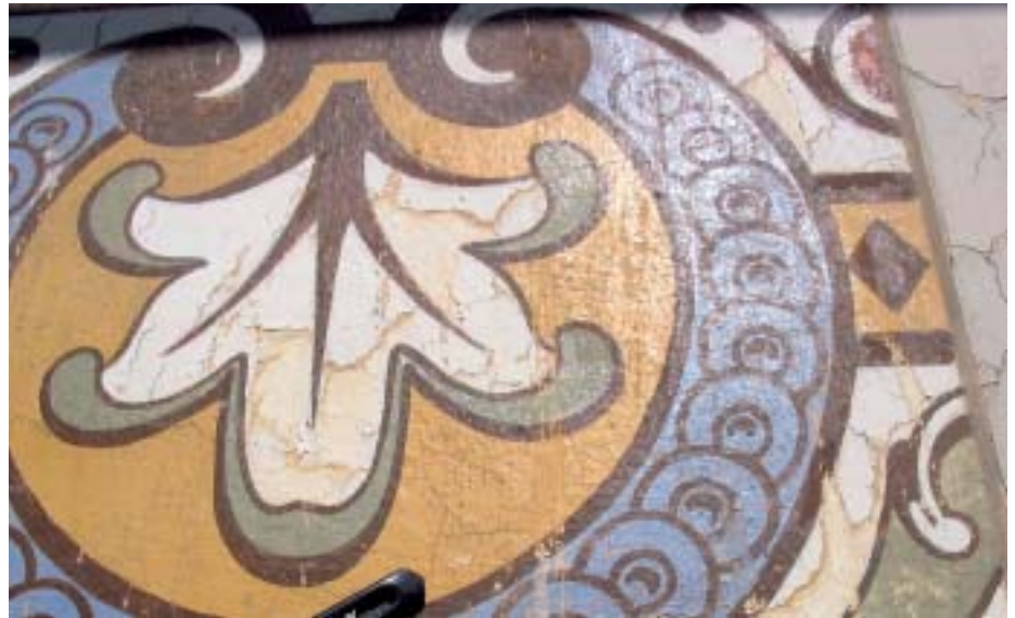
Ornamentik vor der Renovation.
