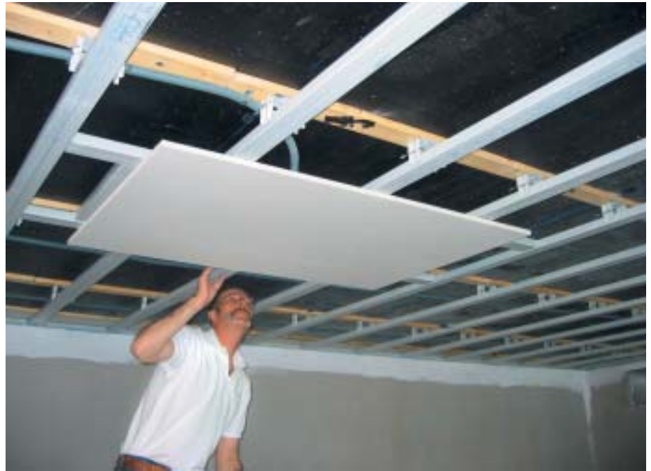
Nach eingehender Kontrolle und einer Funktionsprüfung der Beschallungsanlage kann die Decke vollständig montiert werden.
