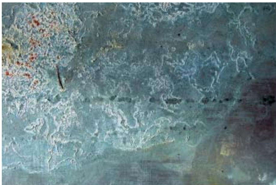
Leichter Weissrost beeinträchtigt die Gebrauchsfähigkeit von Stahl nicht, muss aber entfernt werden, falls ein Anstrich aufgebracht werden soll.
