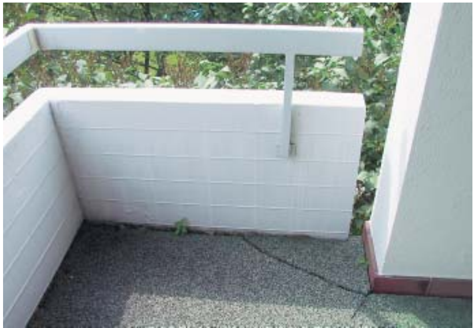
4 Risse in einem Balkonboden lassen Wasser eindringen, das zum Abblättern der Farbe an der Decke des darunterliegenden Balkons führen kann.
