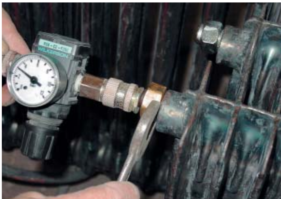
Radiatoren müssen dicht sein und werden deshalb auf einen Druck von 3–4 bar geprüft.
