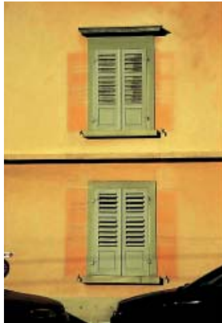
Farbverschiebung einer orangenen Fassade durch Ausbleichen des Rotpigmentes. Die Wandflächen hinter den offenen Fensterläden zeigen die ursprüngliche Farbe.
