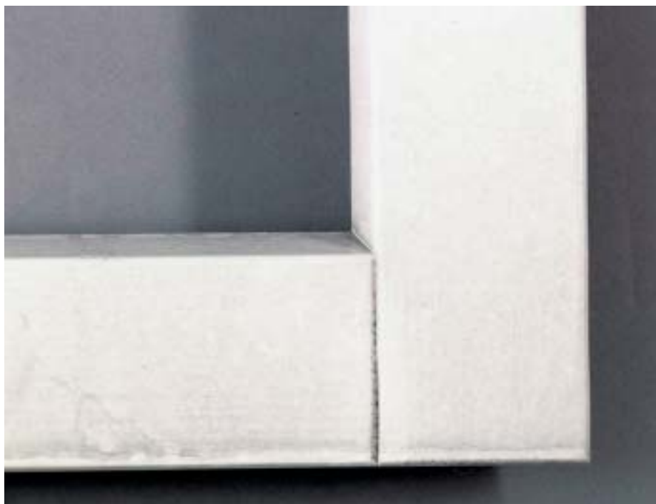
Bild 3 Offene Verbindungsfuge einer einjährig freibewitterten, deckend lackierten Fensterrahmenecke
