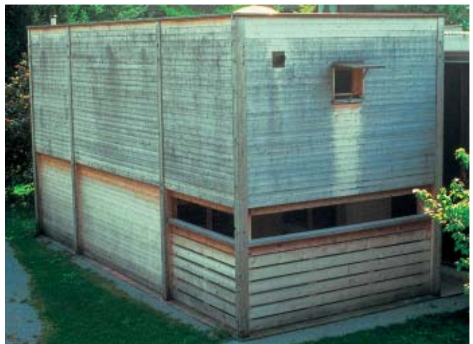
Bild 5 Unbehandelte Holzfassade an einem vordachlosen Gebäude (aus Sell et al. 2001)
