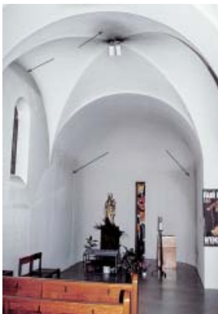
Seitenschiff mit starken Verfärbungen an verschiedenen Stellen
