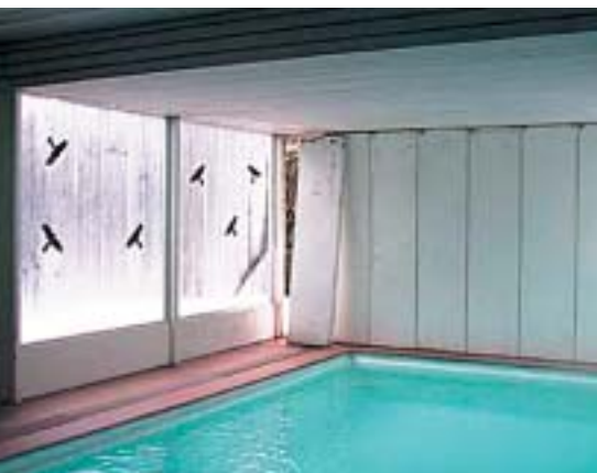
2 Ungenügend isoliertes Schwimmbad
