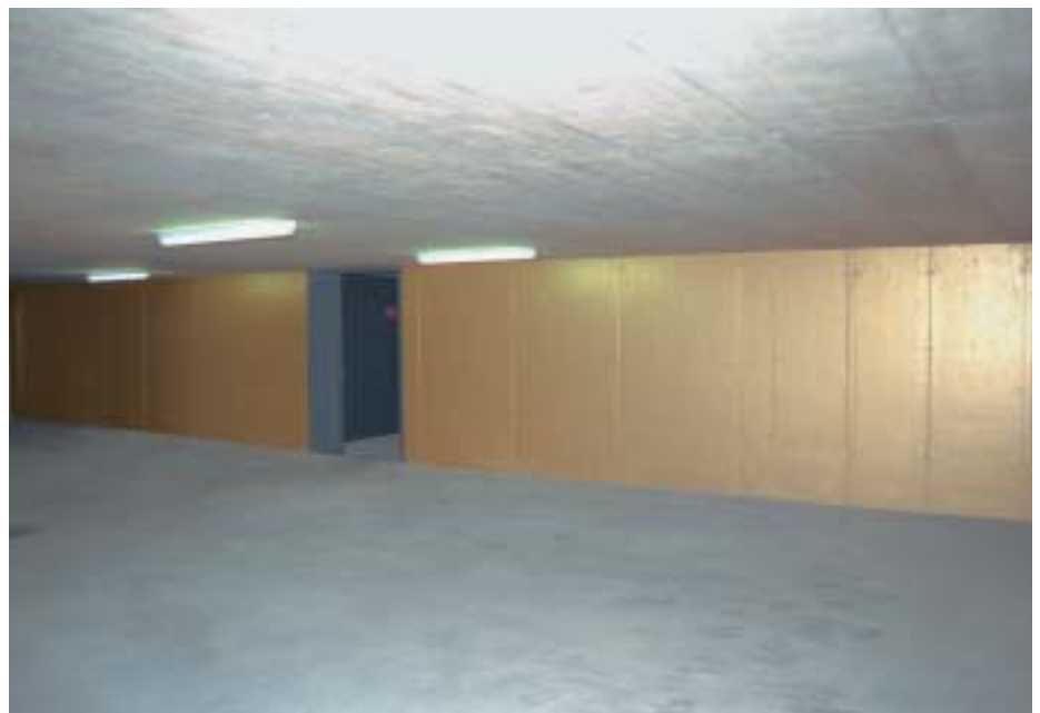
In der Tiefgarage wurde eine Wand direkt auf den rohen Beton mit Goldfarbe in Bürstentechnik gefärbt. Die Farbe wirkt im Zusammenspiel mit dem Betonuntergrund wie goldgewordenes Material. Dreifamilienhaus an der Guggenstrasse 29 in Zollikon. Farbgestaltung: Philipp Wyrsh, Eidg. dipl. Farbgestalter TS/BEF. Architektur: Ken Architekten, Baden, zusammen mit Ariane Dirlewanger
