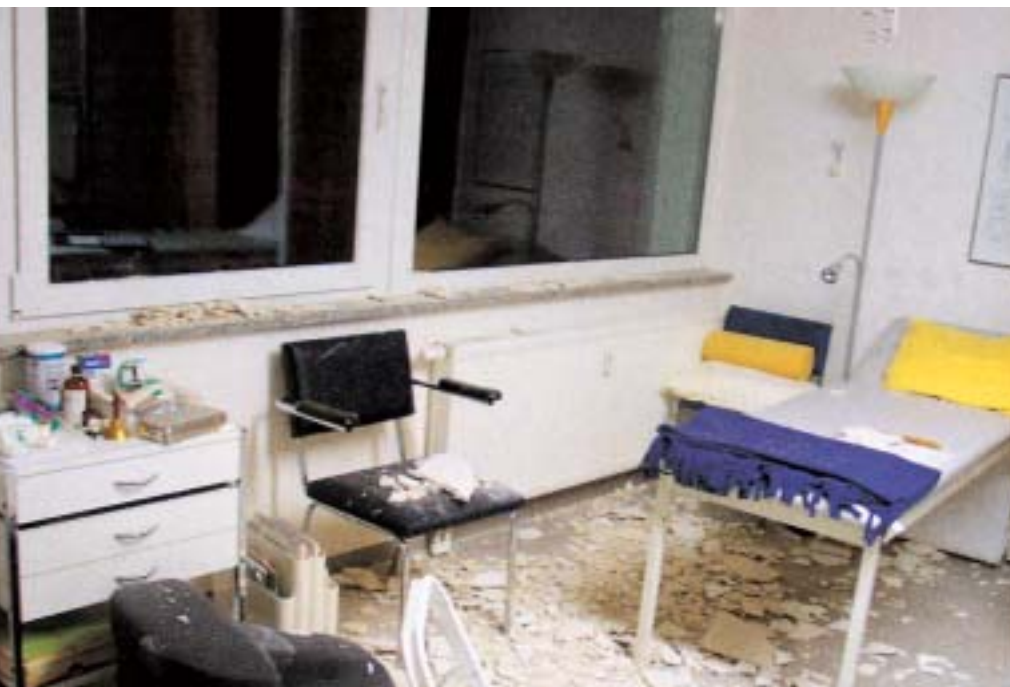
Eine Deckenputzablösung in einer Arztpraxis. Ursache war zu hohe Restfeuchte im Beton
