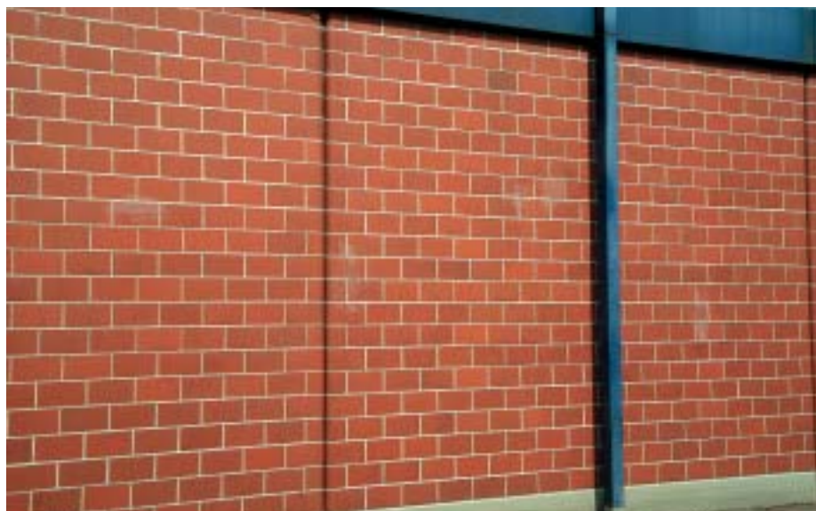
Bild 5 Salzausblühungen an Ziegeln aufgrund fehlender Hydrophobierung
