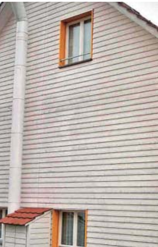
Bild 1: Fassade mit Pilzbewuchs drei Jahre nach Bauabnahme
