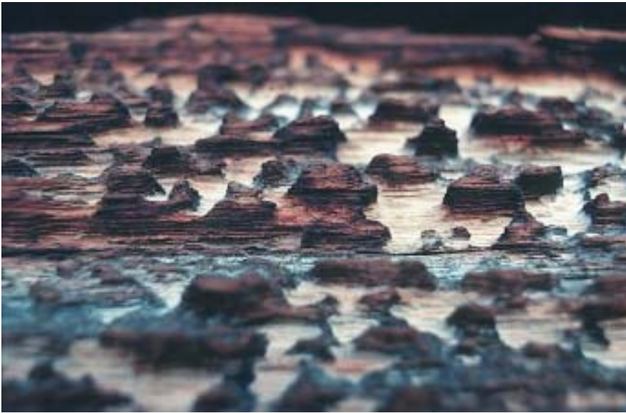
Bild 4: Oberflächenkorrosion von unbehandeltem Holz durch Witterungs- und Pilzeinflüsse
