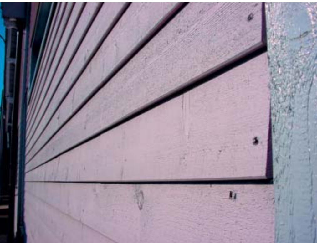
Holzanstriche schützen die Holzfassade vor unerwünschten Verwitterungserscheinungen
