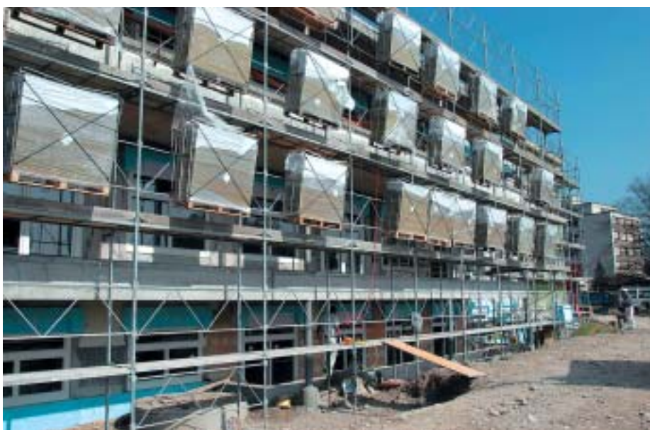
Das Gerüst als «Lagerplatz» erlaubt dem Unternehmer einen freien Gerüstlauf und damit die Erhöhung seiner Arbeitsqualität ohne Kostenfolgen
