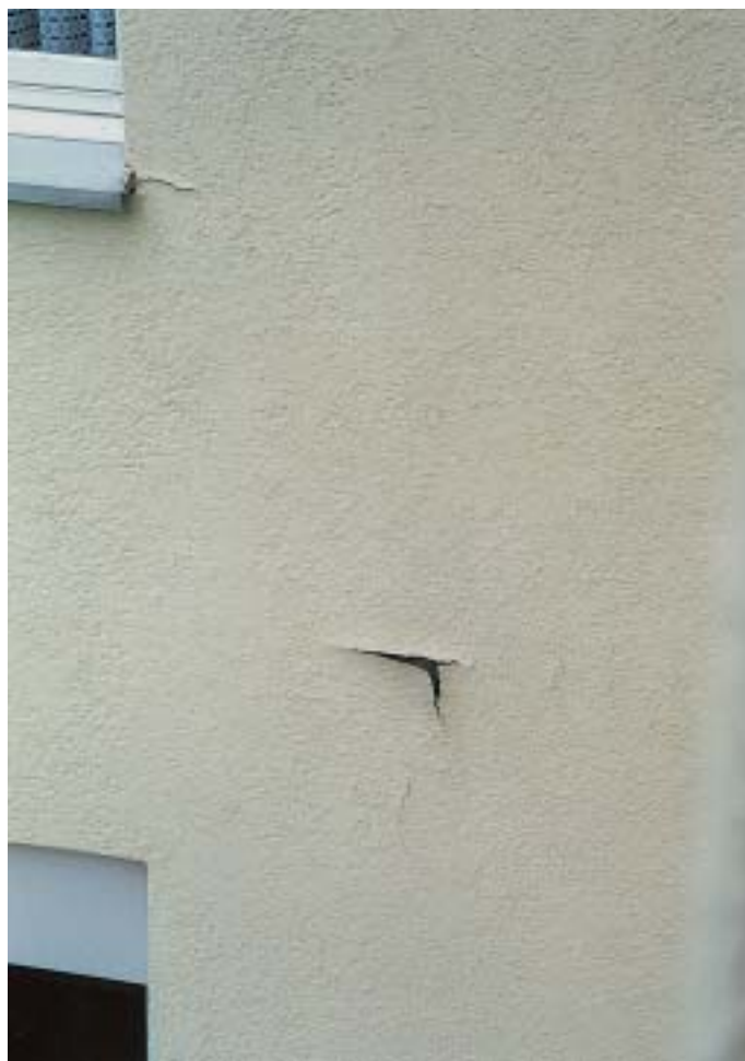
Bild 3: Abplatzen des gestrichenen Deckputzes über den Plattenstössen
