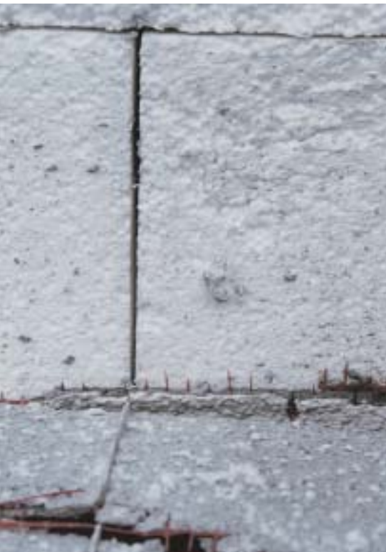
Bild 6: Gleichmässiges Fugenbild lässt auf Schwund der Dämmplatten schliessen
