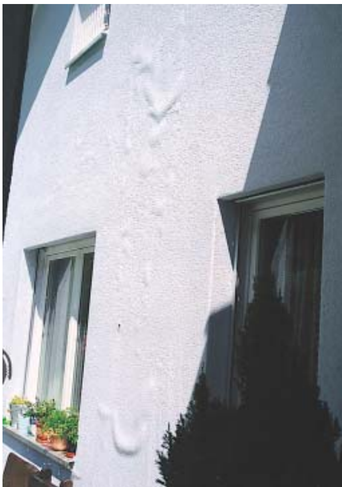
Bild 2: Blasenbildung nach kurzem Anrassen des Deckputzes
