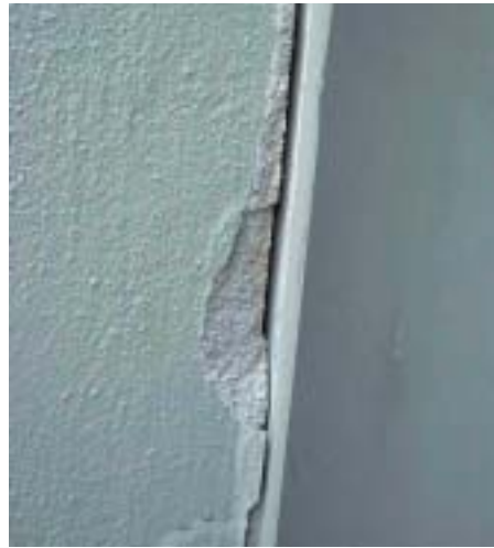
Bild 14: Abriss des Putzes von der Metallzarge. Der Putz wurde teilweise abgedrückt, da sich die Zarge stark verformte und kein Trennschnitt gemacht wurde
