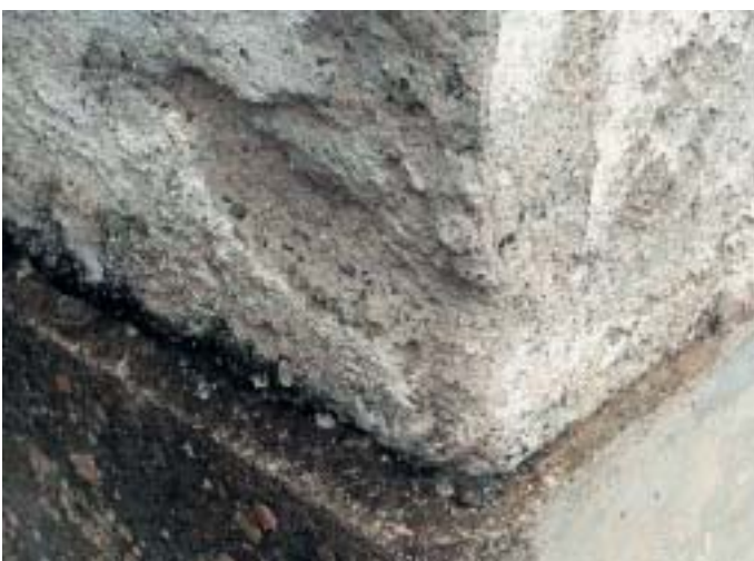
Bild 7: Bei Altbauten muss der Putz vom Sockel getrennt werden. In den meisten Fällen bleibt das Wasser auf dem vorspringenden Sockel liegen und wird vom Putz aufgesaugt
