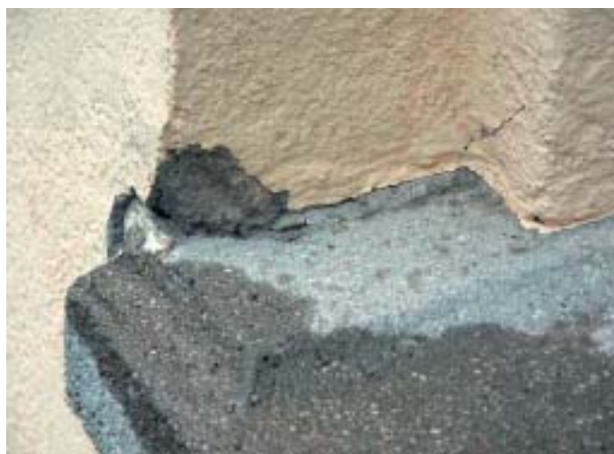
Bild 12: Fehlender Trennschnitt führte zu Putzschaden. Der Putz haftete gut am Kunststeinbank. Die Fensterbank verformte sich unter den Temperatureinflüssen und es kam zum Abriss
