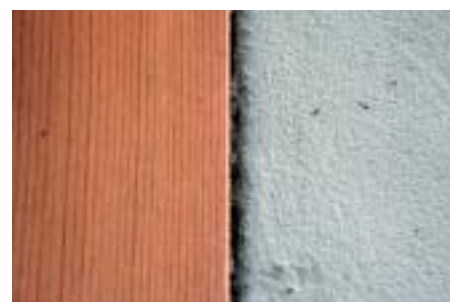
Bild 19: Der Putz wurde beim Anschluss an das Holz nicht geschnitten. Im Laufe der Zeit muss mit Putzablösungen vom Holz und möglicherweise mit Putzschäden gerechnet werden
