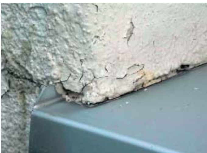
Bild 11: Falsche Fensterbank und falsche Putzausführung. Die Fensterbank weist kein Putzbord auf. Der Putz wurde ohne Trennschnitt auf die Fensterbank geführt, die als wasserführende Ebene gilt
