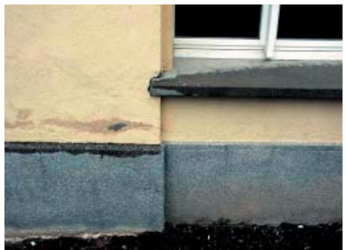
Bild 8: Auf dem Bild ist gut erkennbar, wie das Wasser auf dem vorspringenden Sockel zu einer Durchfeuchtung der Anschlusszone und zu einem Putzschaden und Flecken führte
