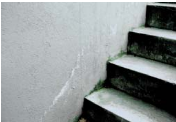
Bild 3: Ausblühungen und Anstrichablösungen infolge der fehlenden Trennung des Grund- und Deckputzes (mineralischer Deckputz) von der wasserführenden Ebene
