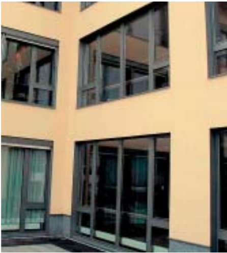
Bild 13: Moderne Fassaden werden immer häufiger mit grossen Fenstern, die eine Metallzarge aufweisen, gestaltet. Der Anschluss an diese Metallzargen muss wasserdicht sein und die Verformungen der Zarge schadlos aufnehmen können
