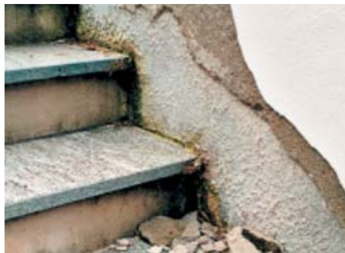
Bild 2: Ablösung des Putzsystems über den Treppentritten. Gut sichtbar sind die Algen, die eine anhaltende Feuchtigkeitseinwirkung auf den Putz anzeigen
