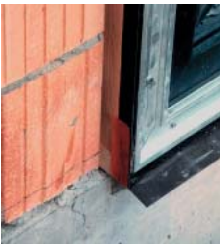
Bild 16: Fenster mit einer Metallzarge und einem Holzrahmen erfordern eine sehr sorgfältige Planung der Anschlussdetails
