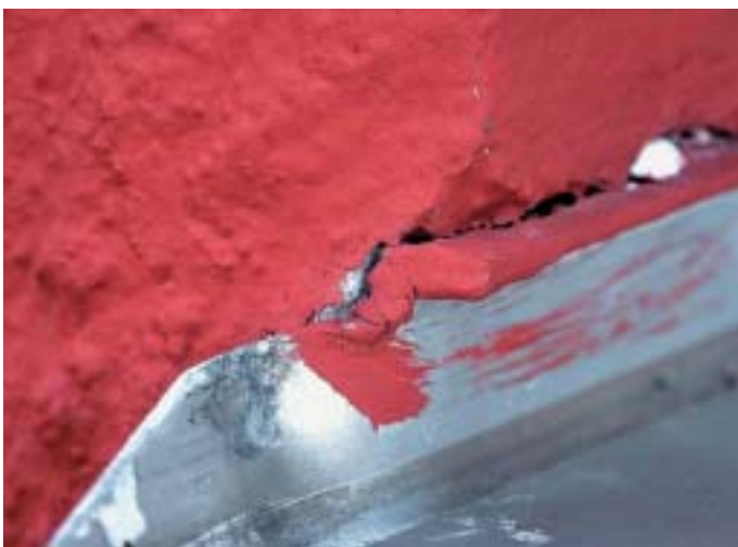
Bild 9: Falscher Anschluss des Putzes an die Fensterbank. Der Putz wurde nicht auf das Putzbord geführt
