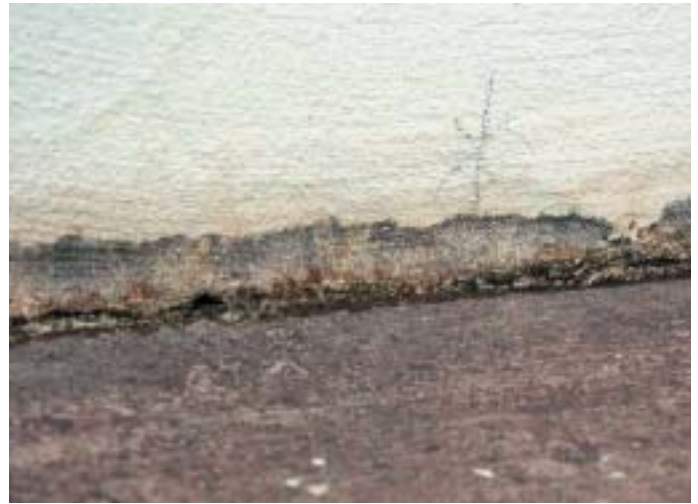
Bild 6: Der Putzanschluss an eine geschlossene Belagsfläche, hier eine Betonplatte, erfordert einen Trennschnitt. Damit wird der Putz von der wasserführenden Ebene getrennt
