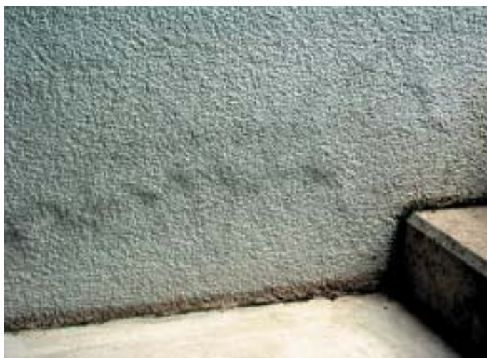
Bild 1: Blasenbildung im Deckputz infolge fehlender Trennung des Putzes von der wasserführenden Ebene. Das Wasser wird vom Grundputz aufgesaugt und steigt, je nach kapillarem Verhalten des Grundputzes, bis auf eine bestimmte Höhe
