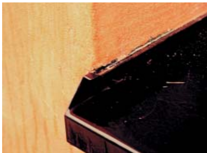
Bild 10: Abriss zwischen Putz und der schwarzen Fensterbank. Da der Putz nicht bündig mit dem Putzbord abschliesst, besteht ein Schadenpotenzial
