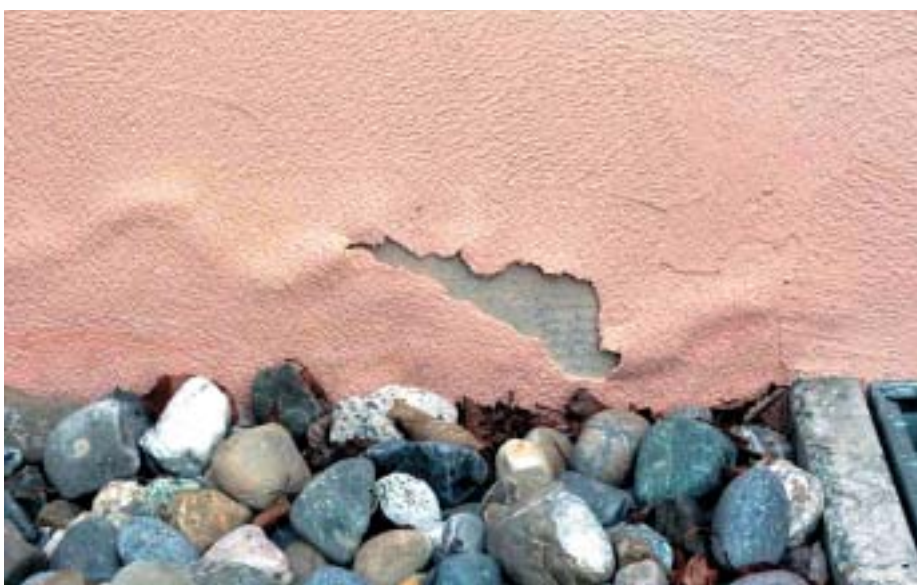
Blasenbildung und abgelöster Deckputz. Die Schutzschicht (Schwarzbeschichtung) wurde nicht bis zur Terrainkante geführt
