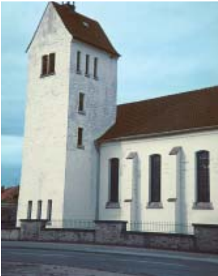
Bild 4: Anstrichschaden durch Verseifung des Bindemittels
