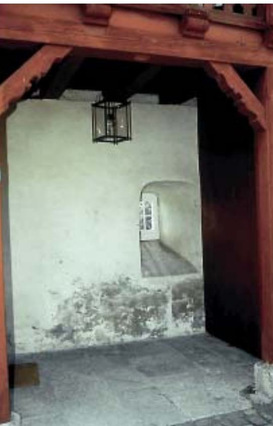
1 Vom Untergrund abgesprengte Beschichtungen. Hier ist eine Sanierung notwendig
