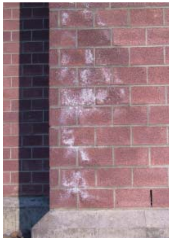
2 Sichtbar die Salze, die als Fremdsubstanz in das Bauwerk gelangten
