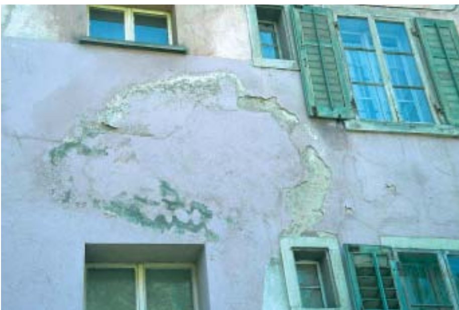
4 Durch die kapillare Wasseraufnahme können grosse Mengen Wasser in die Fassade gelangen
