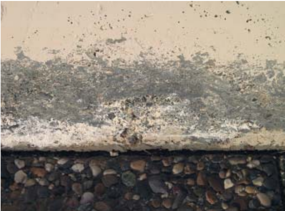
3 Das Wasser kann vertikal aus dem Grundwasserbereich wie auch horizontal von der Fassadenoberfläche aufgenommen werden
