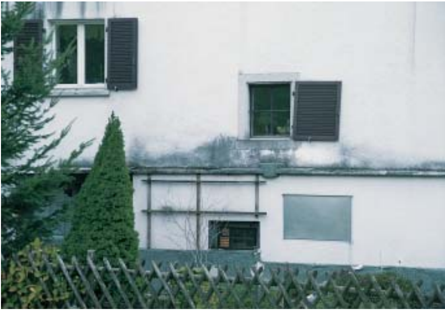
4 Pilzbefall durch aufsteigende Feuchtigkeit an der Oberkante des Vorbaus
