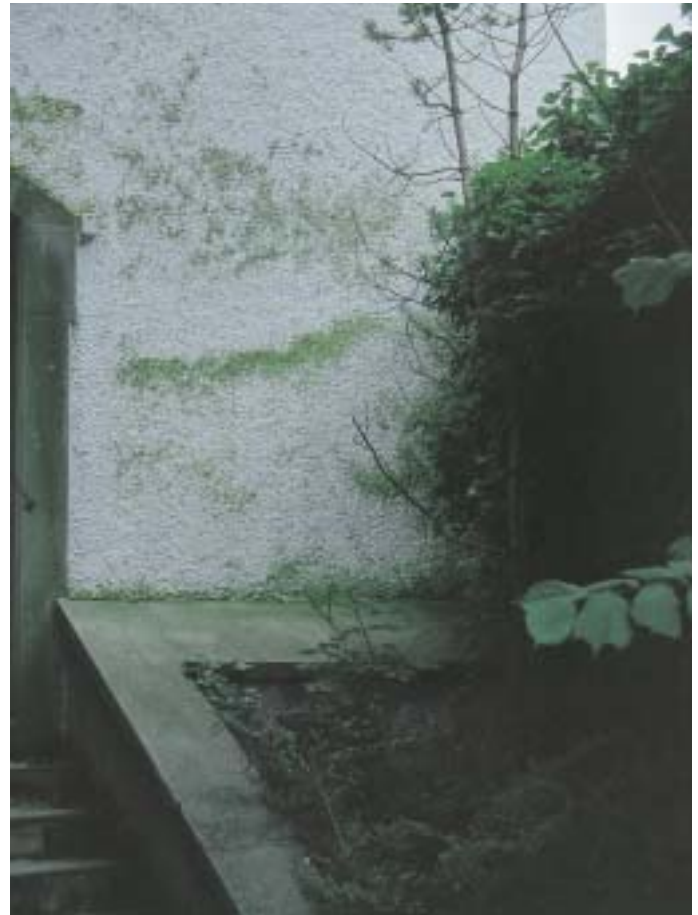
3 Algenbefall an Vordach durch schlechte konstruktive Lösung, die übrige gedämmte Fassade ist nicht befallen
