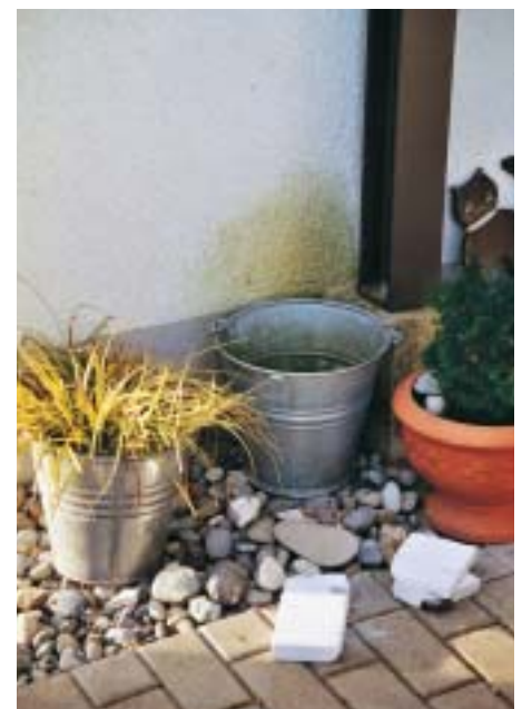
5 Algenbefall durch zurückprallendes Wasser
