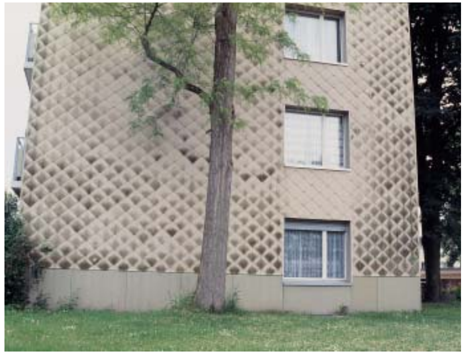
6 Pilzbefall auf Eternitfassade
